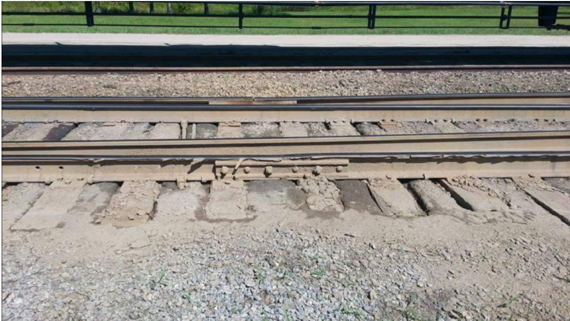
Figura 14. Ascenso de finos de la plataforma a causa del efecto de bombeo.
