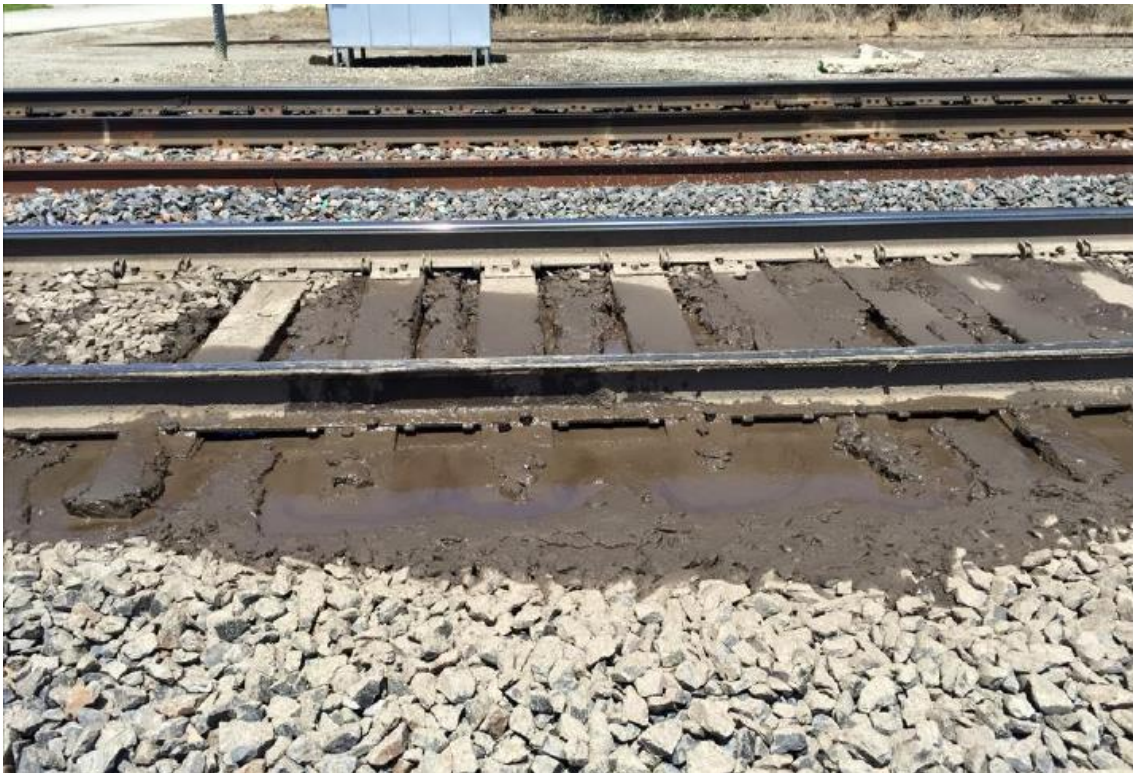
Figura 16. Efecto de bombeo incrementado por ingreso de agua debido a deformaciones excesivas de la vía.
