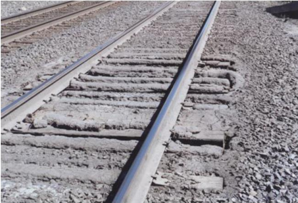
Figura 15. Balasto colmatado por ascenso de finos.
