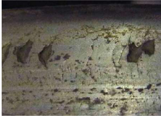
Figura 47: Desprendimiento de metal de grietas finas superficiales que se encuentran unidas, [30].
