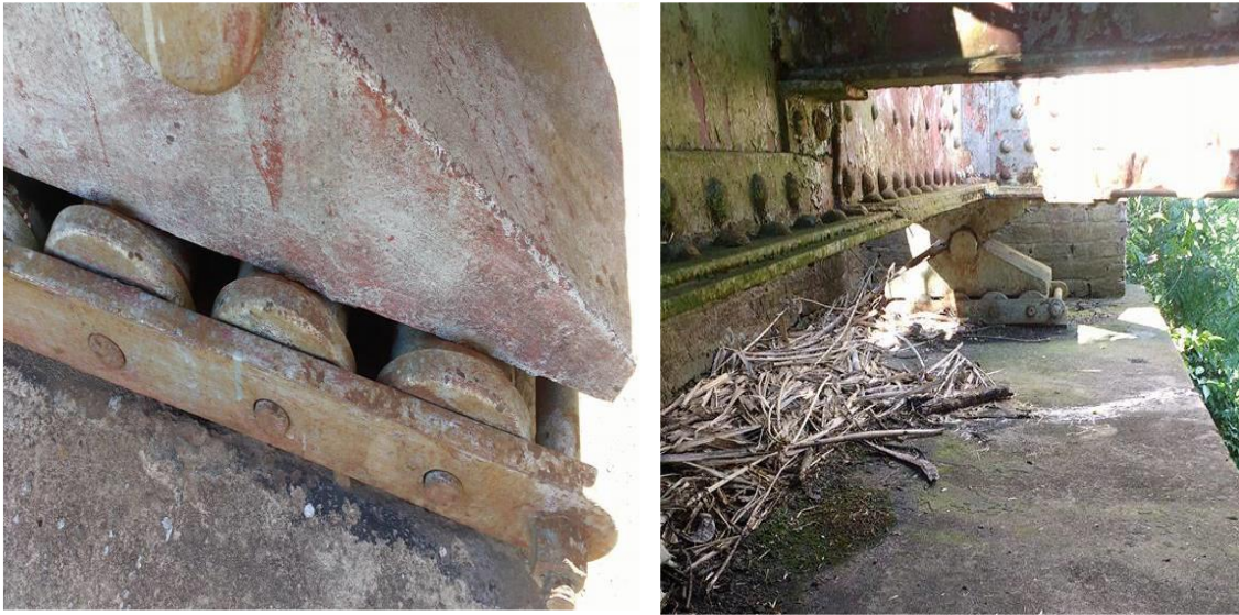
Apoyos móviles de dos puentes distintos, Argentina
