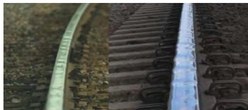
Figura 34. Corrugaciones en el riel.
