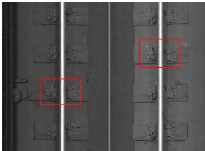
Figura 39. Inspección con sistema de visión identificando placas de asiento en una posición incorrecta [2].
