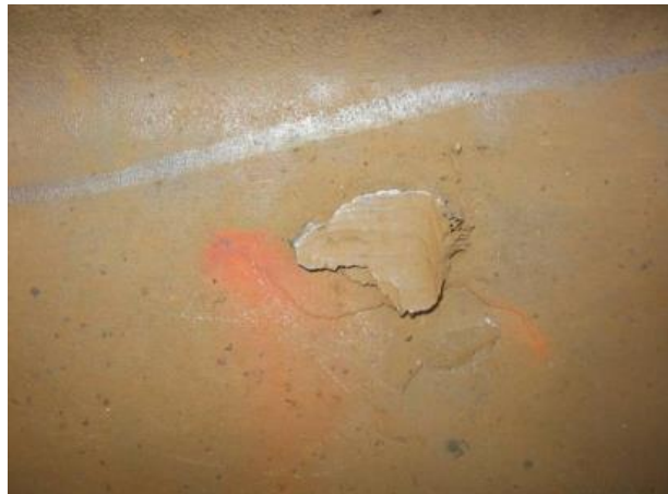
Figure 63. Desarrollo de un defecto en el alma a partir de una soldadura de cable eléctrico.
