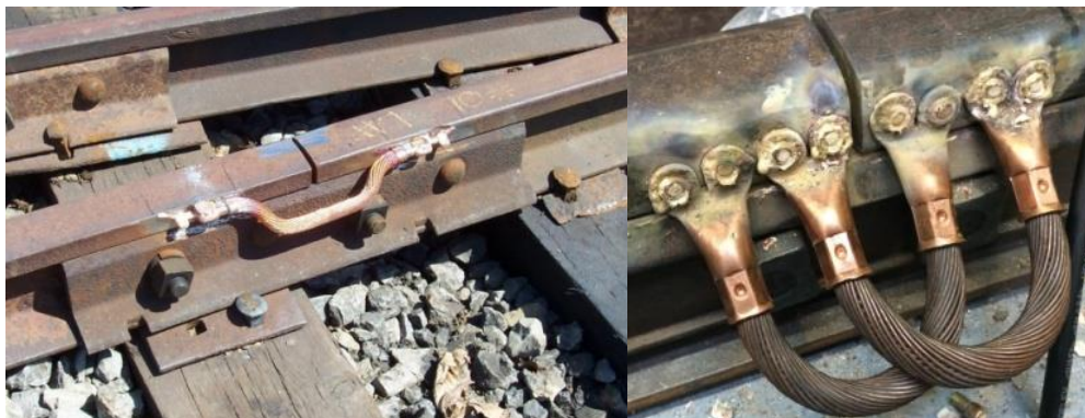
Figura 64. Conexiones eléctricas sobre la cabeza de rieles.
