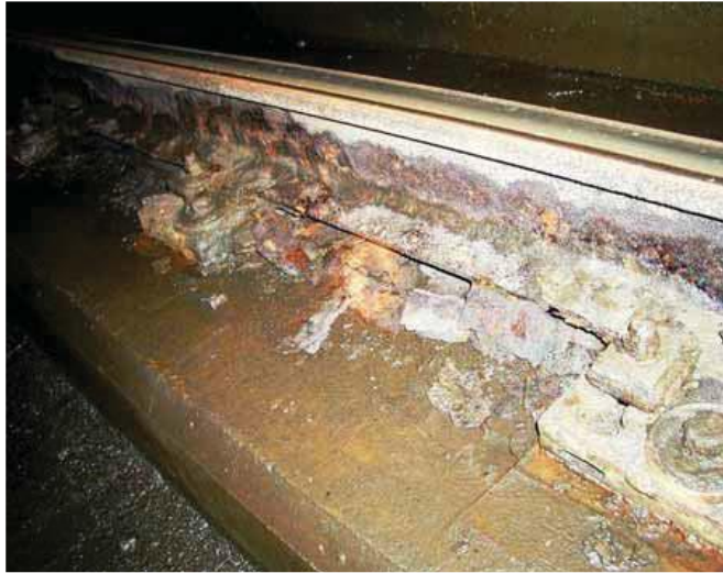
Figura 53. Corrosión sobre el riel, sistema de fijación y placas.
